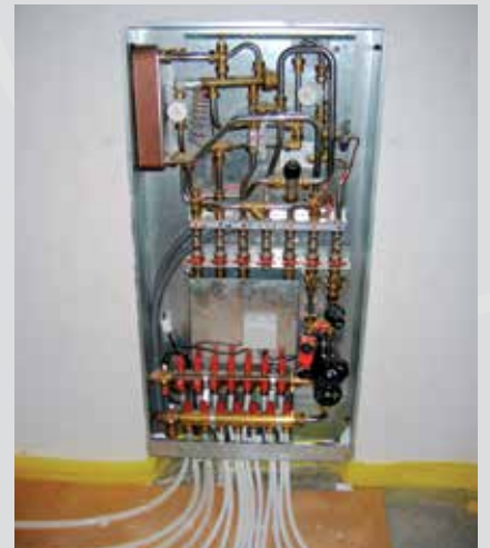
Daire istasyonunun yerden ısıtma dağıtım ünitesi ile gömme montajı.
