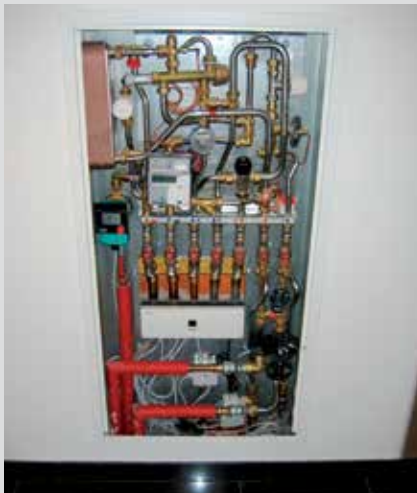
Daire istasyonunun yerden ısıtma dağıtım ünitesi ve kontrolörlere gömme montajı.
